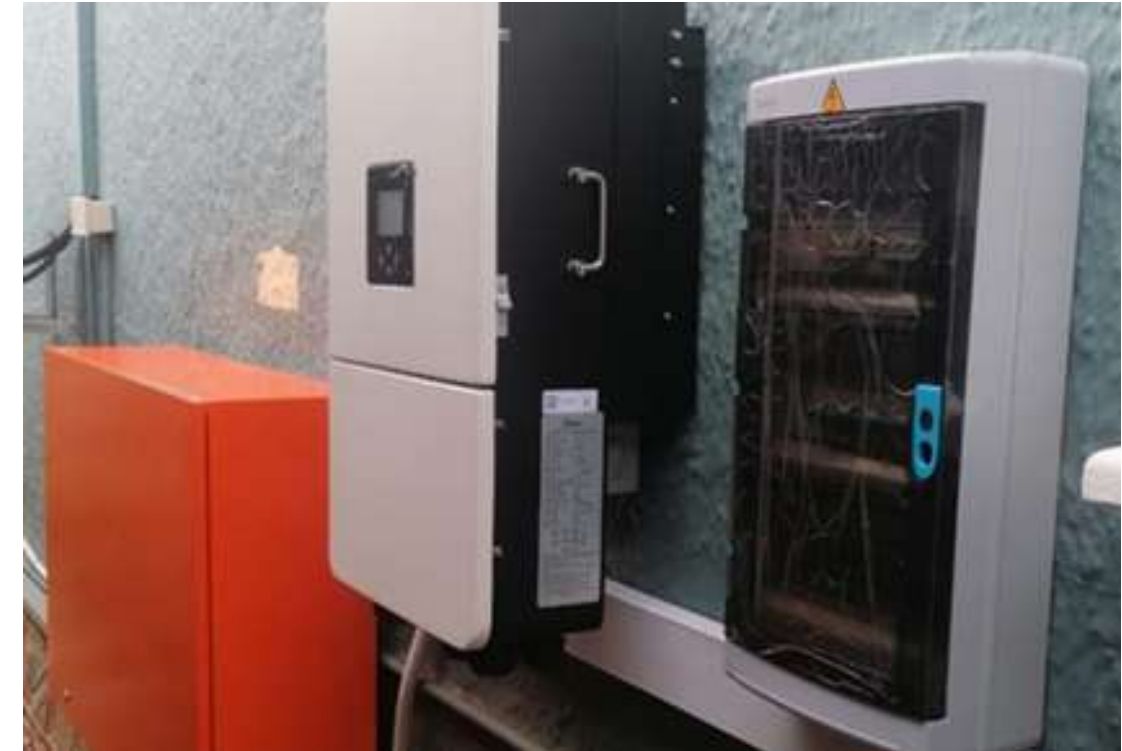
12KW 3P + 20KW LI BATTERY
